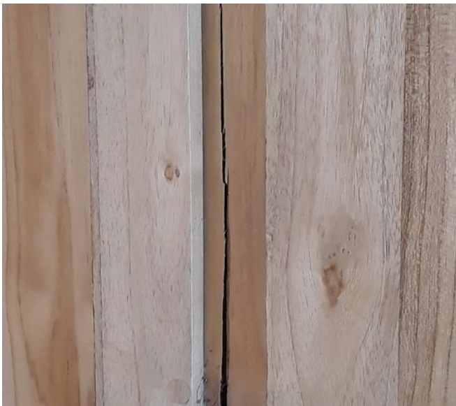
Panel de tablas unidas. Se reventó porque fue fijado en los extremos. Observe que no fue la pega que cedió.
